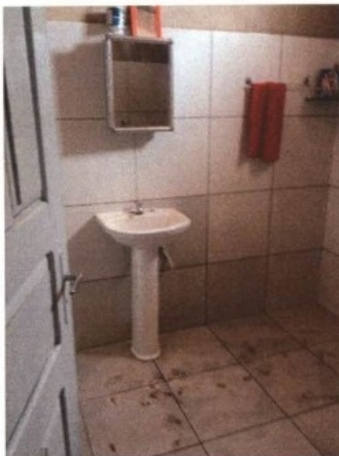
Foto 3: instalação sanitária da casa em que estava alojado o trabalhador.
