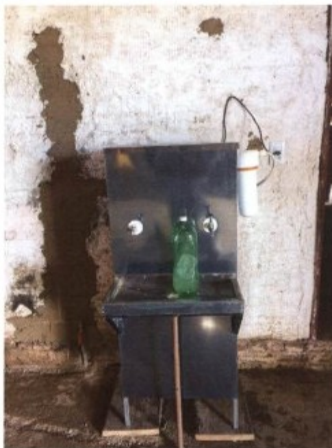
Figura 1 Bebedouro sem aterramento
