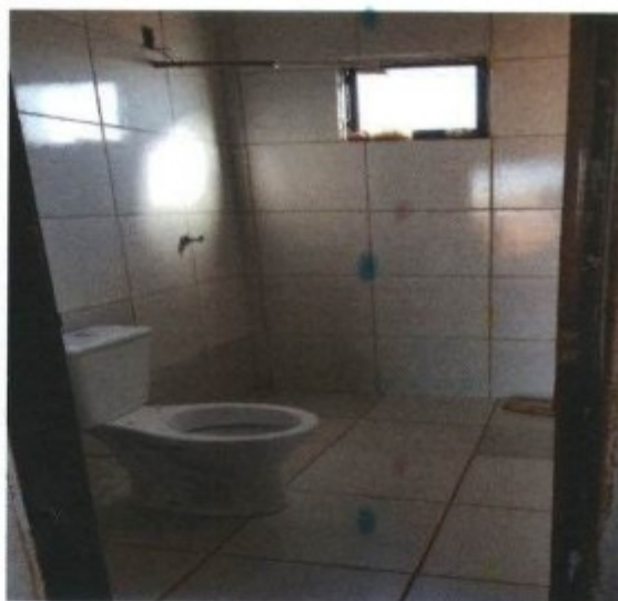
Foto: Banheiro alojamento
