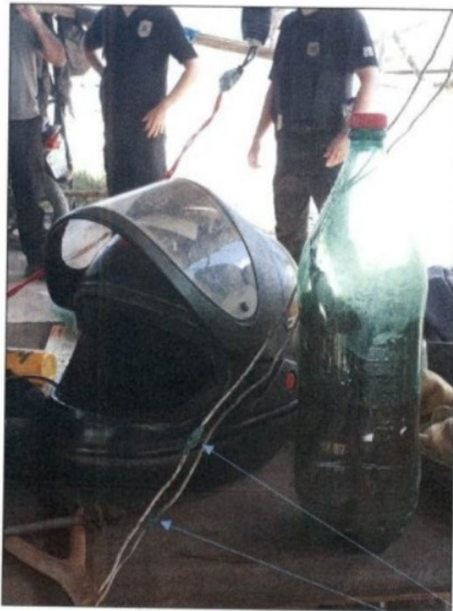
Foto: Fiação elétrica energizada e "isolada" com pedaços de saco plástico .
