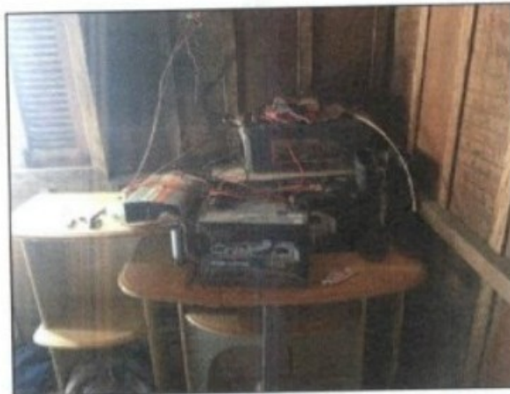
Foto: Baterias do sistema de geração de energia do alojamento, sem proteção nos terminais.
