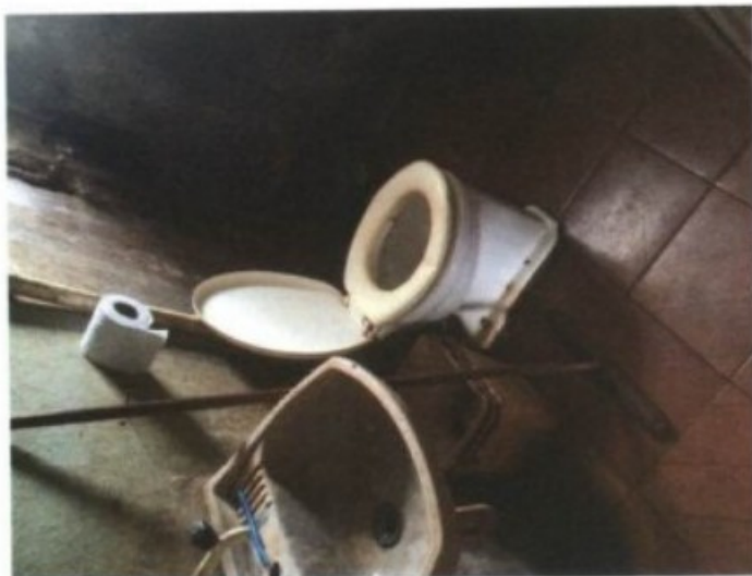
, Pia e sanitário do Banheiro.
