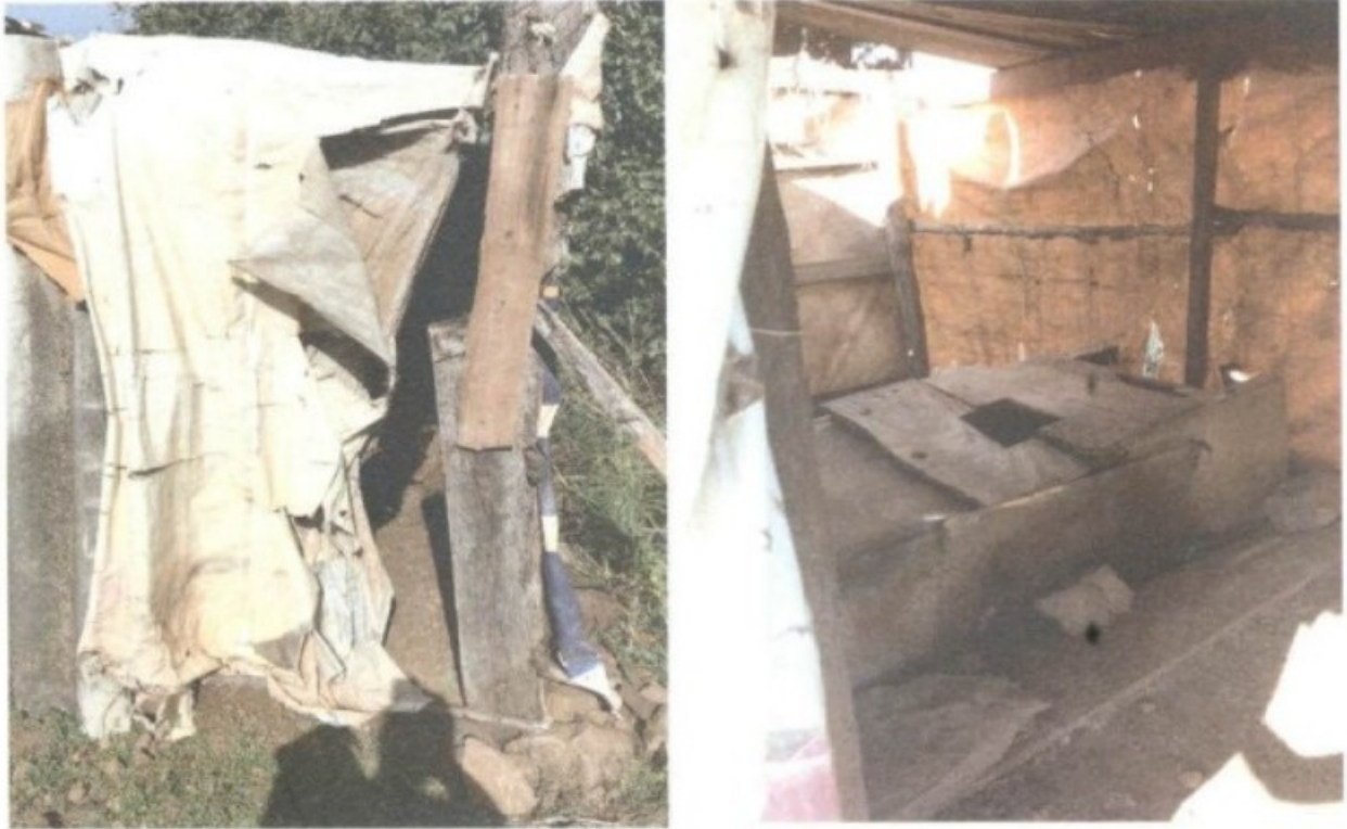
Entrada da barraca e tablado que deveria ser usado como assento sanitário.
