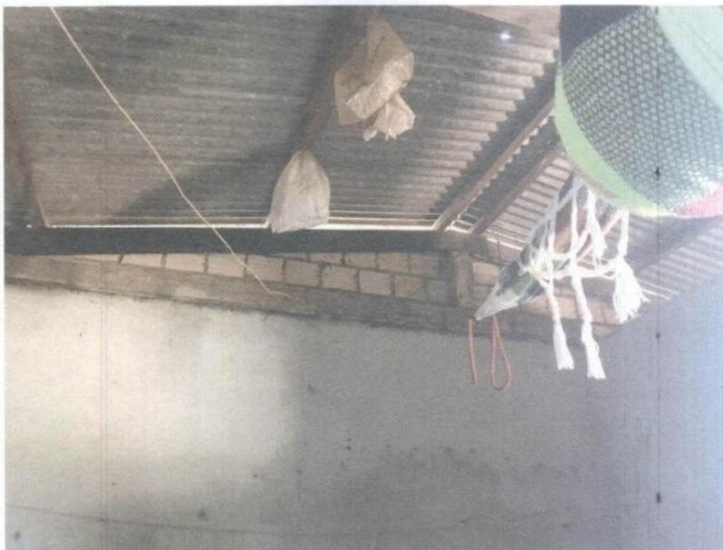
ALOJAMENTO DOS CAMPONESES – FALTA DE FORRAÇÃO (CAUSA DE DESCONFORTO TÉRMICO)
