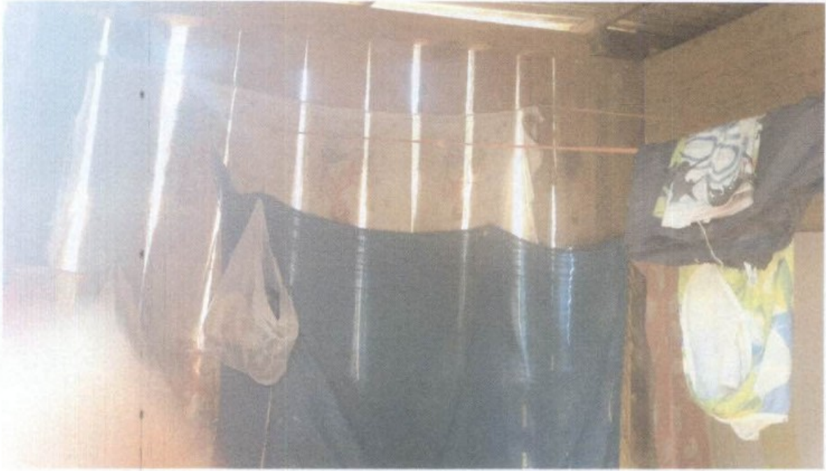
VISTA INTERNA DO CÔMODO DE MADEIRA, COM FRESTAS NAS PAREDES
