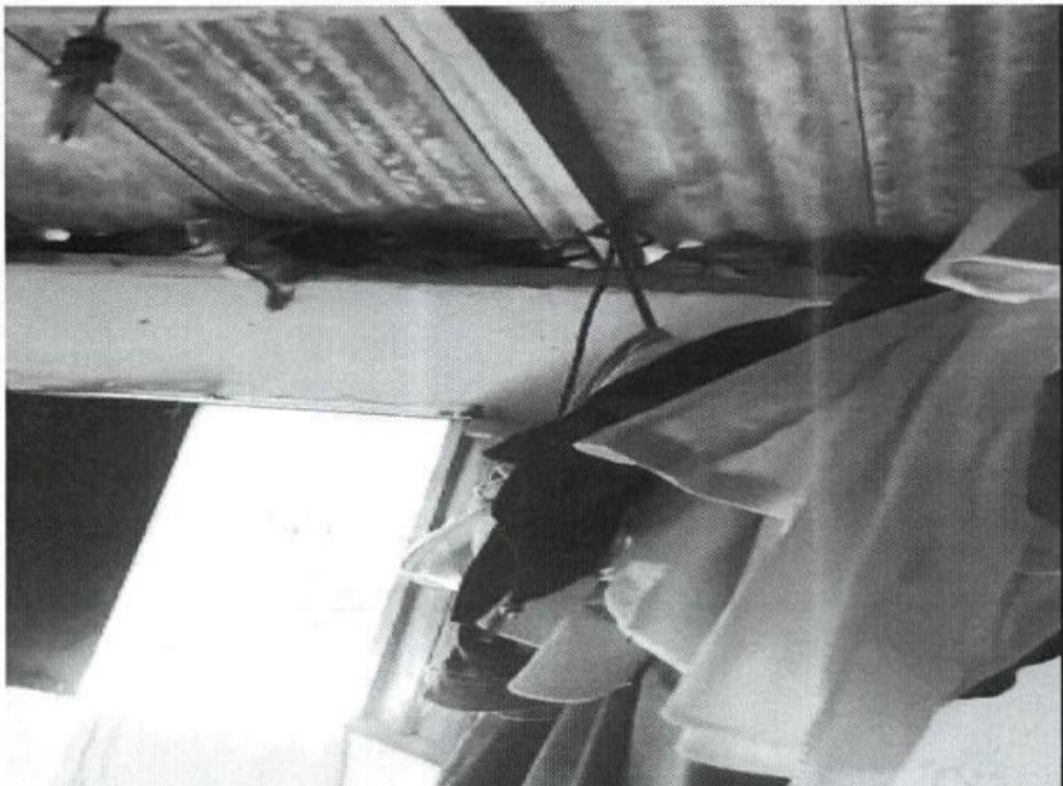
FOTO 5 – FRESTAS NA COBERTURA
