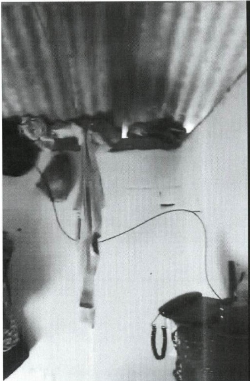
FOTO 6- FRESTAS NA COBERTURA
