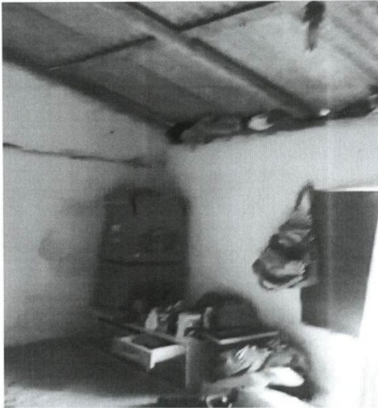
FOTO 4- FRESTAS NA COBERTURA
