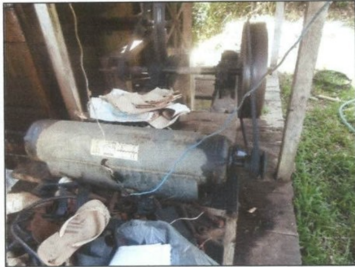
Foto: Instalações elétricas do local onde ficava a roda d'água.
