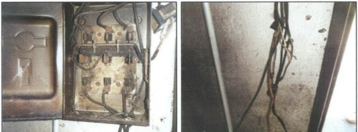
Fotos: Fiações elétricas com partes vivas expostas e sem proteção.
