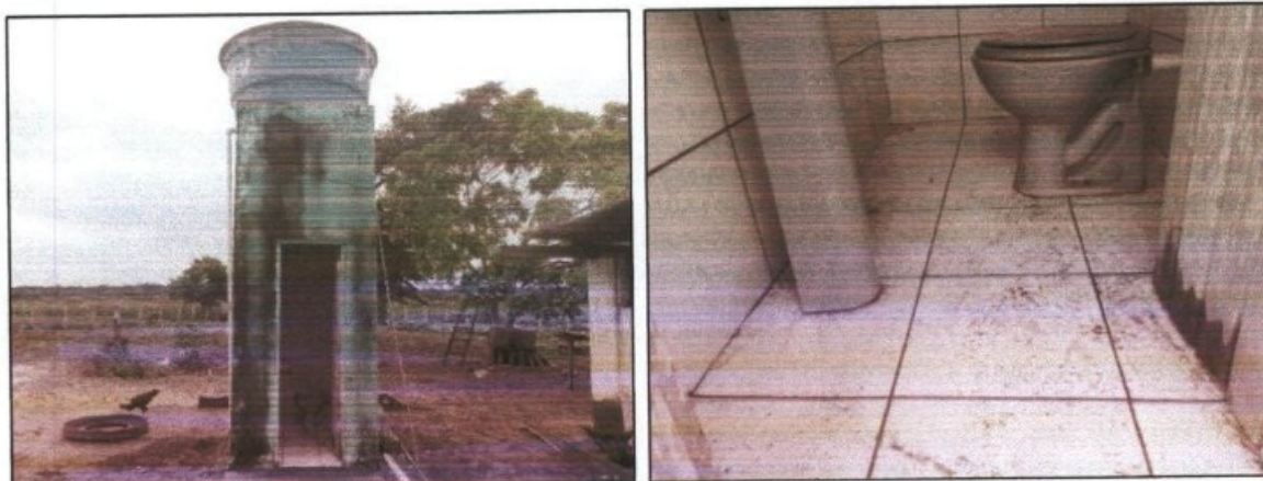
Fotos: Banheiro que não podia ser usado pelo trabalhador, devido ao retorno dos dejetos da fossa.
