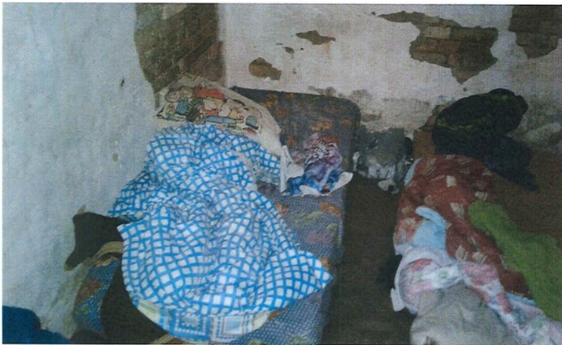
Foto 05 - Colchões instalados diretamente no piso de concreto. Detalhe: paredes úmidas.
