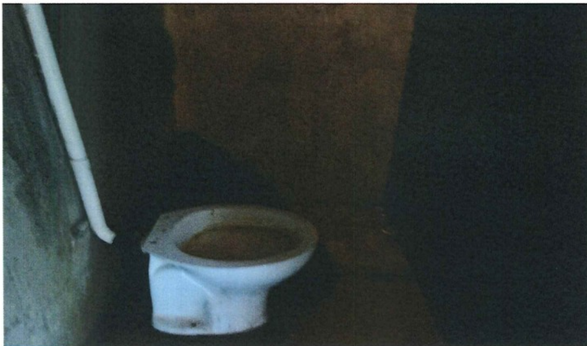
Foto 13 - Instalação sanitária em más condições de higiene e faltando material para higiene e asseio corporal.
