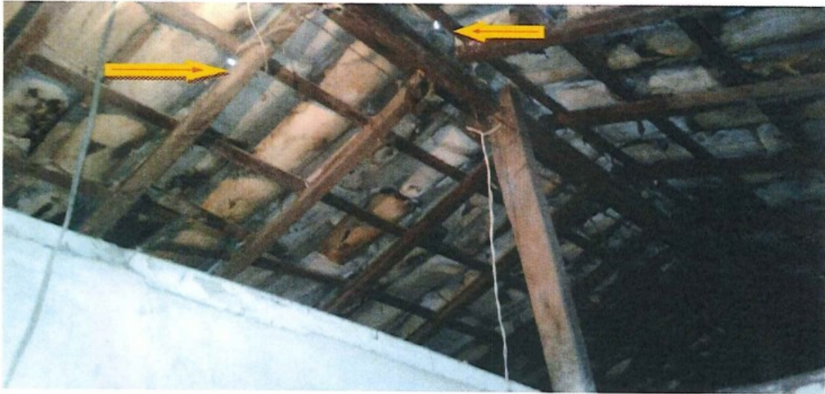
Foto 17 - Detalhe: a) telhado com pontos sujeitos à goteiras; b) telhas desgastadas e emboloradas.
