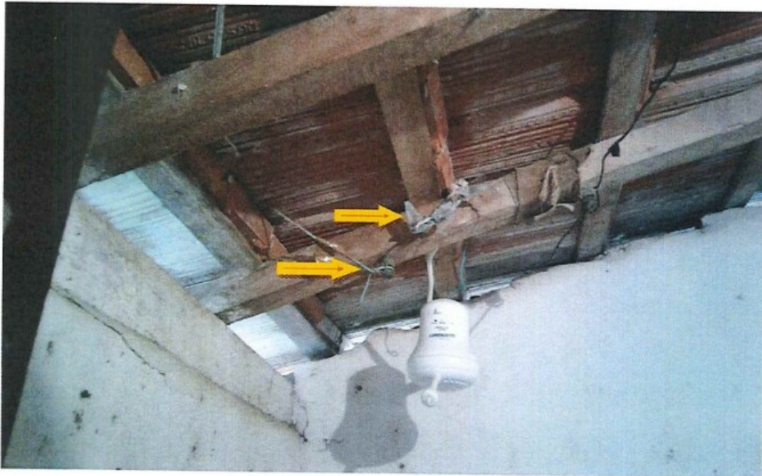
Foto 15 - Detalhe: chuveiro apenas frio (desconectado da rede elétrica).
