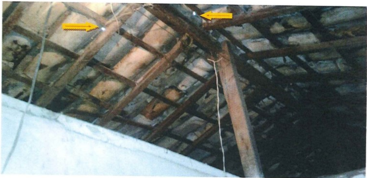
Foto 12 - Detalhes: a) Alojamento/casa, sem forro; b) Telhado sujeito à goteiras.
