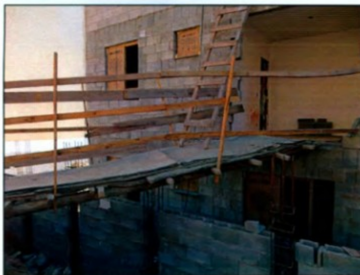
Detalhe das características construtivas da passarela e da escada de mão nela apoiada para acesso ao terceiro pavimento, situação expressamente vedada em norma.
