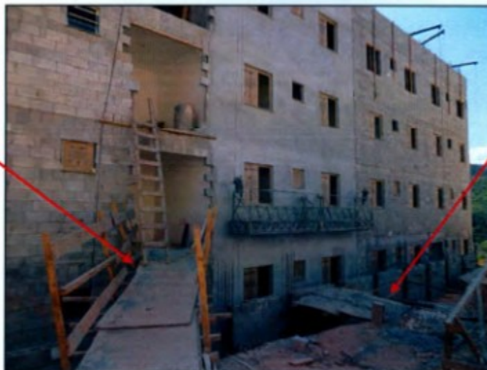
Passarela, escada de mão e plataforma de trabalho em uso na obra, instaladas sem observância de requisitos mínimos de segurança previstos em norma para prevenção do risco de queda de altura.
