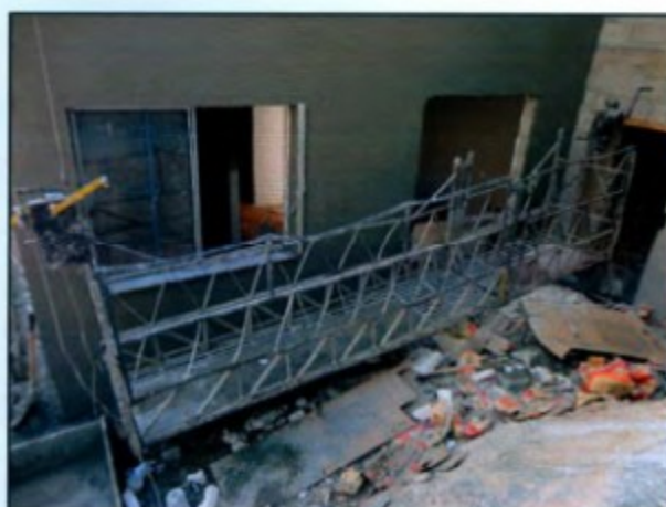
Entulho no piso de trabalho.
