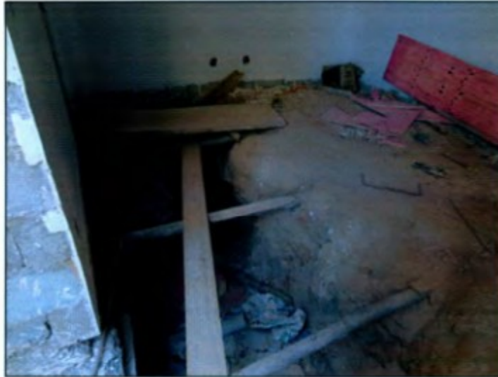
Aberturas no piso de trabalho.
