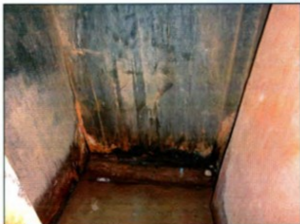
Detalhe do precário estado de conservação do gabinete de chuveiro.
