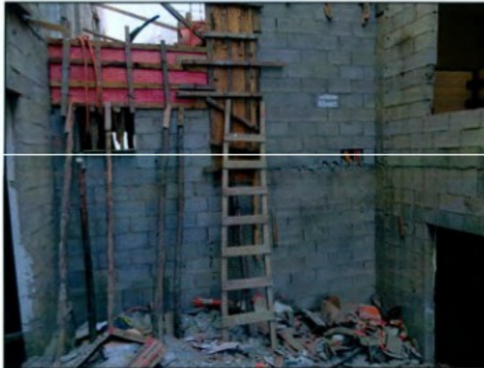
Escada de mão sem fixação, apoiada em amontoado de entulho.
