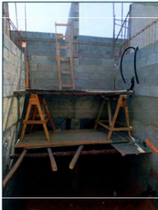
Plataforma de trabalho totalmente improvisada em com risco de queda de altura.
