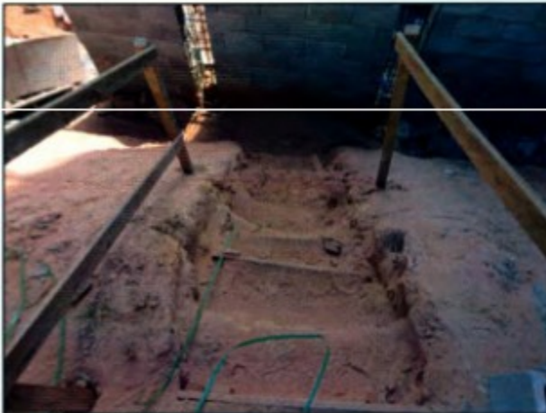
Escada improvisada no barranco.
