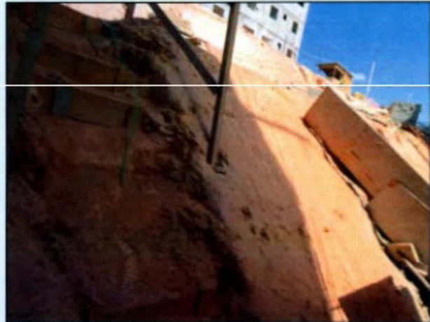
Detalhe da situação dos degraus da escada e da limitação do corrimão.
