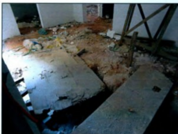
Desorganização do canteiro de obra: entulho e abertura no piso
