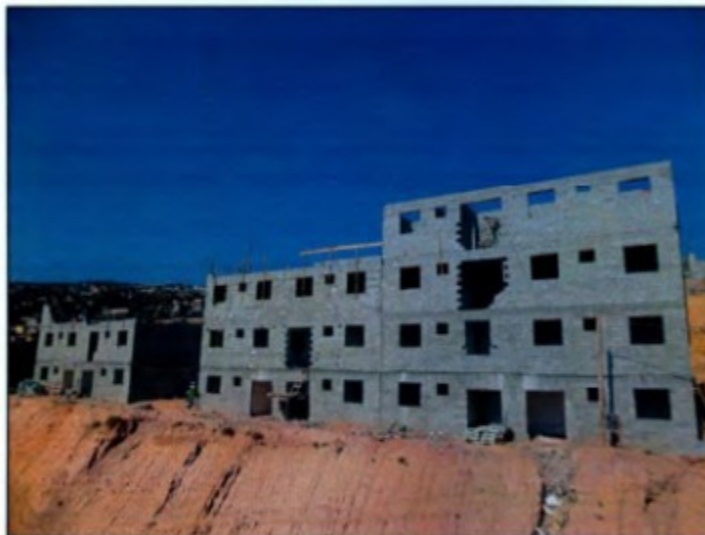
Periferia sem proteção no último pavimento do bloco à esquerda e em metade do quarto pavimento do bloco à direita.
