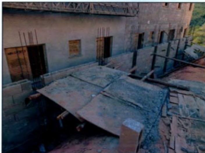
Detalhe da plataforma de trabalho em situação irregular.
