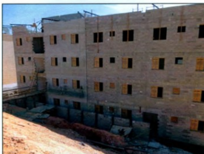
Periferia parcialmente desprotegida (lado esquerdo).
