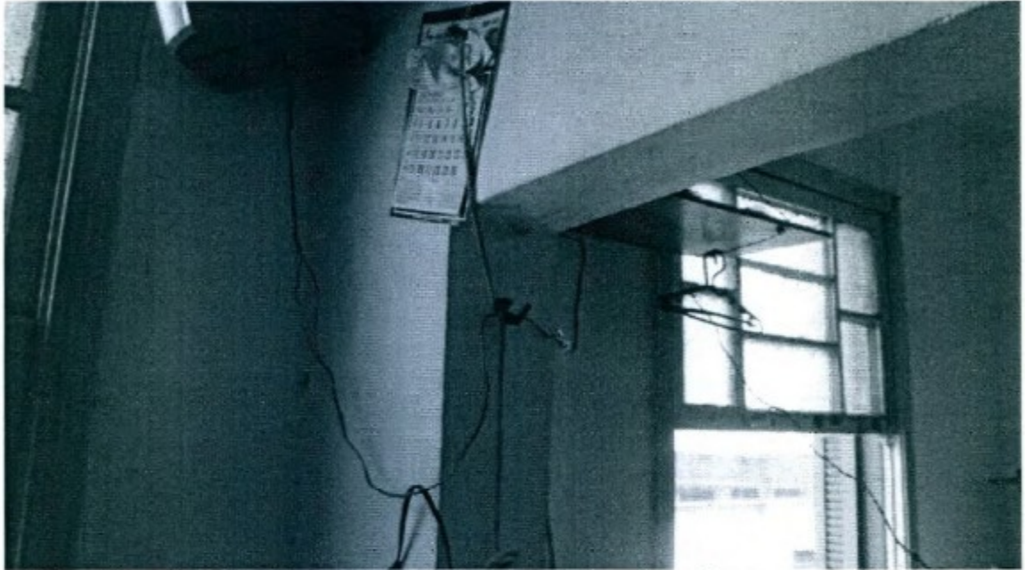
oficina: "varais" de fios elétricos com emendas irregulares e gambiarras encontram-se em todo o cômodo.
