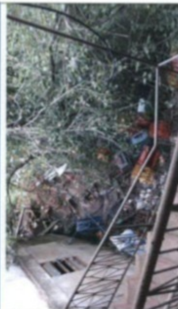
Escada percorrida pelo trabalhador até o local em que improvisou um chuveiro.
