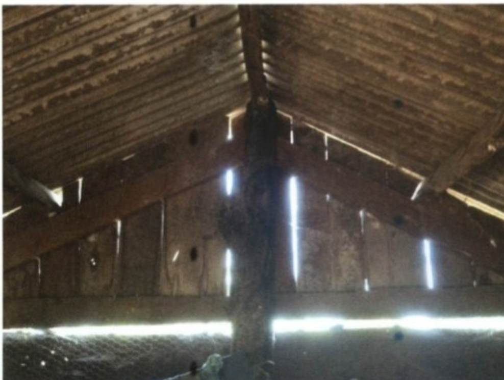
Detalhe da parte interna do paiol, relevando espaçamento entre as telhas e a superfície de apoio, por onde entrava água da chuva. - Foto tirada pelo AFT [REDACTED] em 12/01/2017.
