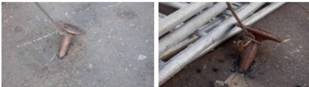
Figura 9 e 10 Cabo de aço amarrado.
