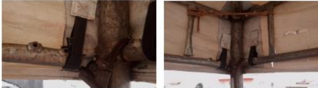
Figura 13 e 14 Estrutura da tenda quebrada e amarrada com corda.
