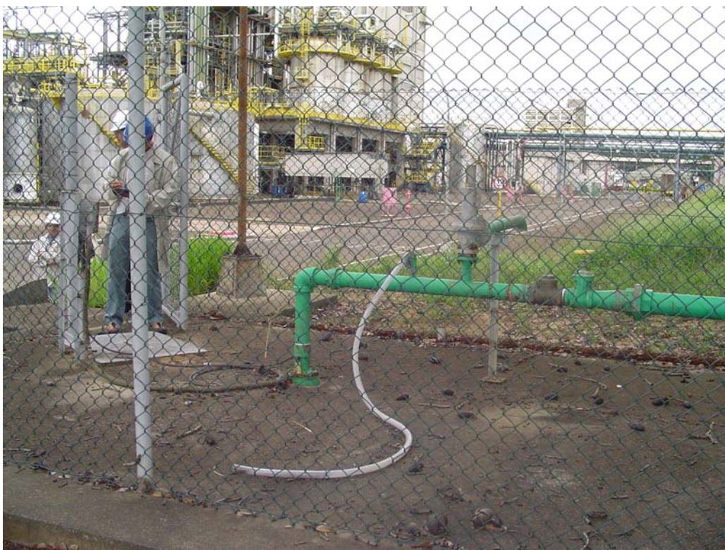
Foto 3 : Instalações do Poço 3 na área da empresa Kraton
