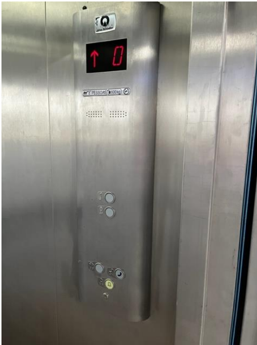
Figura 33 - Botoeiras sem sinalização em baile.
