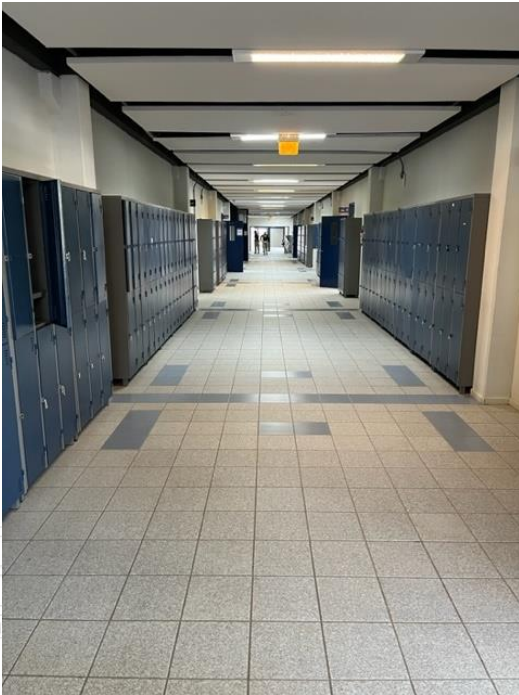
Figura 28 - Corredores sem sinalização tátil.
