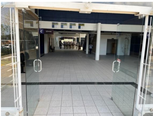
Figura 36 - Porta de vidro sem sinalização.
