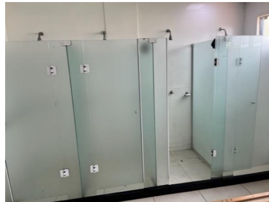
Figura 45 - Chuveiros no vestiário.
