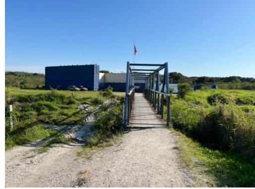
Figura 12 - Ponte com piso irregular.
