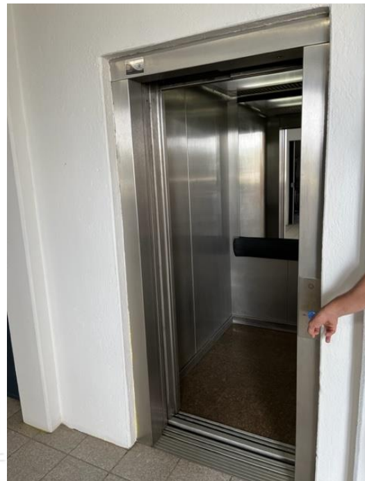
Figura 32 - Elevador com portas e medidas menores do que o indicado em norma.
