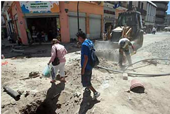
Danos provocados por uma obra
