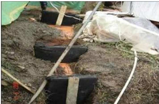
Filtros para tratamento de efluentes resultantes do corte de tijolos
