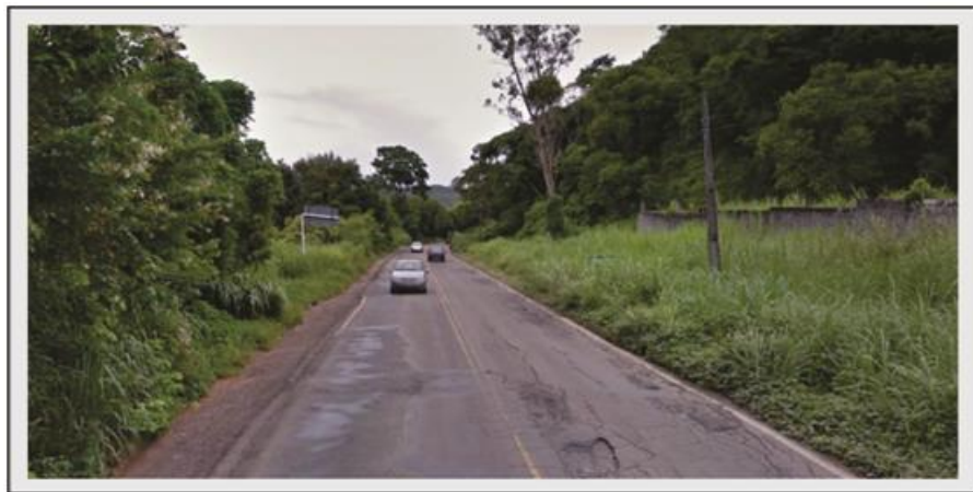
Figura 1. Trecho Precário da BR-415
