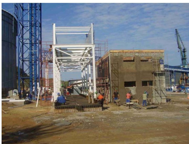
FIG 18 – NOVAS INSTALAÇÕES DE PESAGEM
