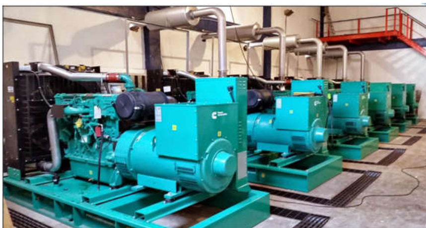
Imagem 26 – Geradores do Porto Ilha
