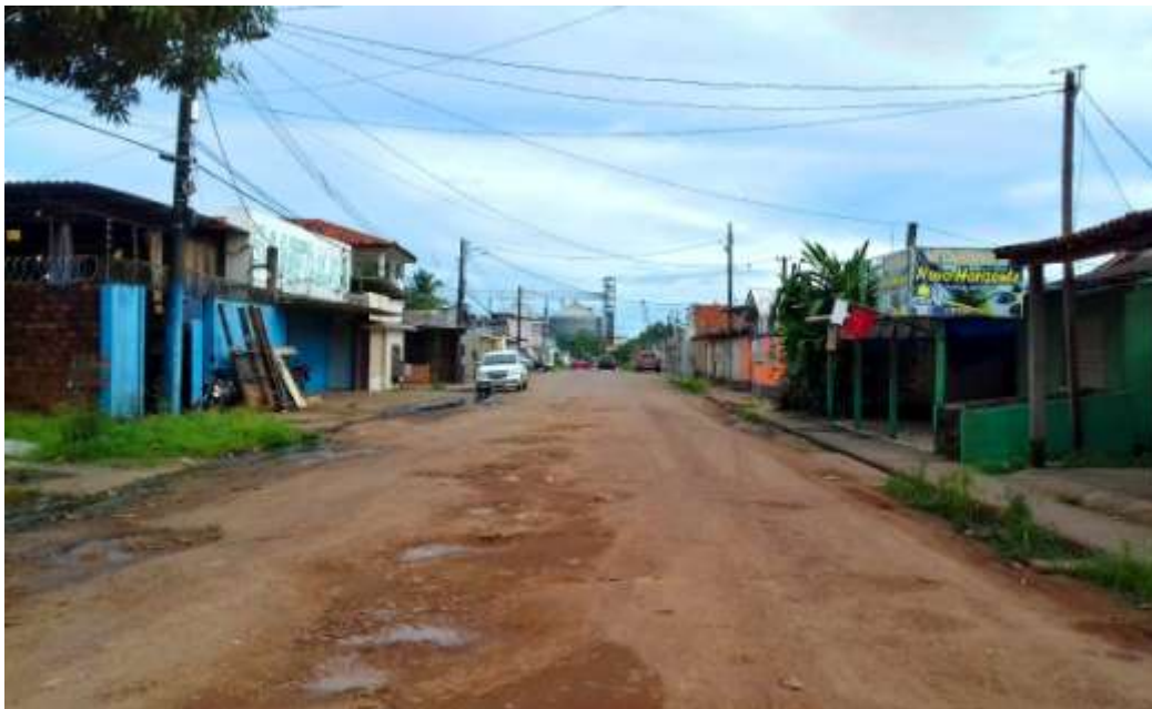
Figura 64 – Condições viárias da avenida Oderica Marques Pereira Fonte: Imagem fornecida pela CDSA (2018).
