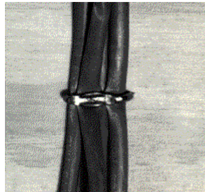
Figura 2 - Cabo amassado (incorreto)
