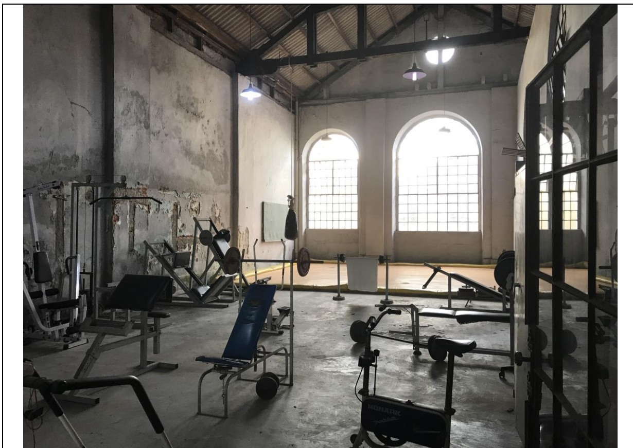
Foto01 – Área destinada a prática de atividade física na DPF/RGE/RS, praticamente inutilizável em razão de seu estado de conservação
