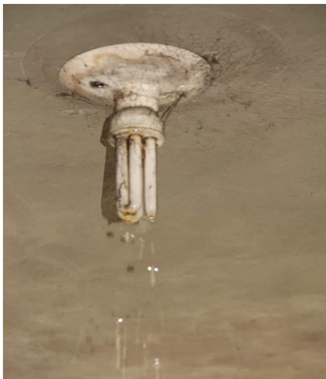
Figura 1- Problemas de infiltração na rede elétrica
