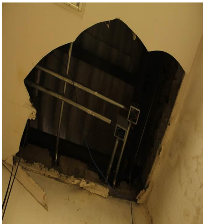
Figura 3 - Teto do setor administrativo quebrado
