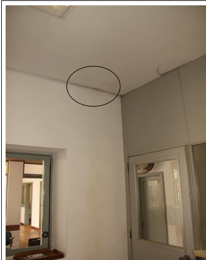
Figura 5 - Sala do Plantão com infiltrações
