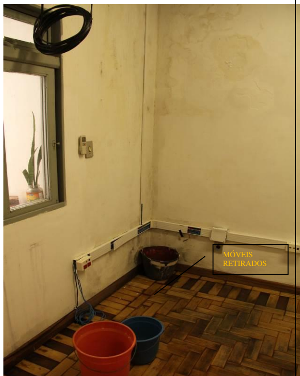
Figura 2 - Inúmeras goteiras no setor administrativo em razão de teto quebrado
