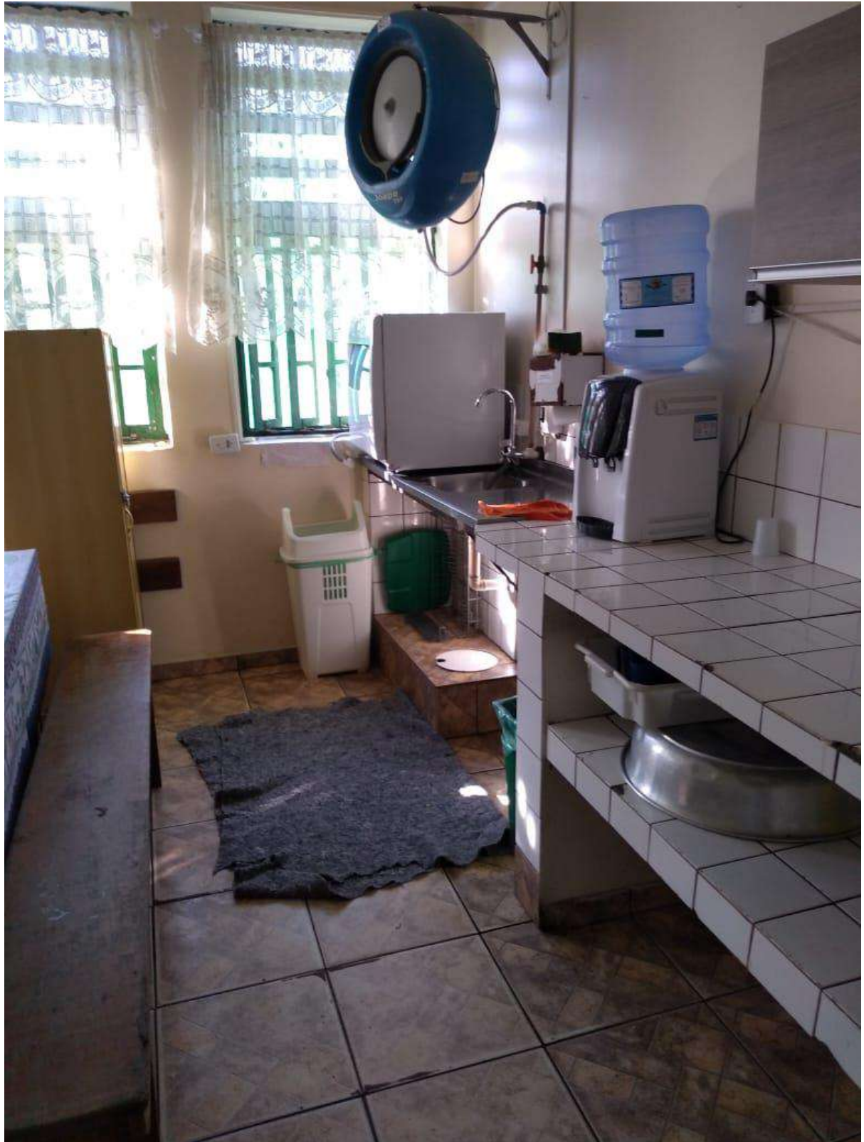
Refeitório da Unidade Masculina sem lavatórios e disponibilização de álcool gel (24 moradores na unidade)
