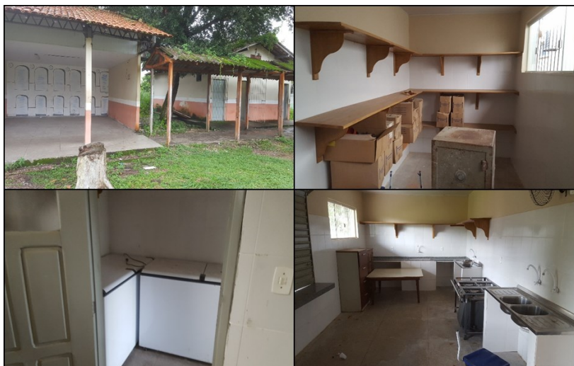
Imagem 6: Fotos da situação da cozinha, depósito e refeitório da EEEM Magalhães Barata (tiradas em 23/03/2017)
