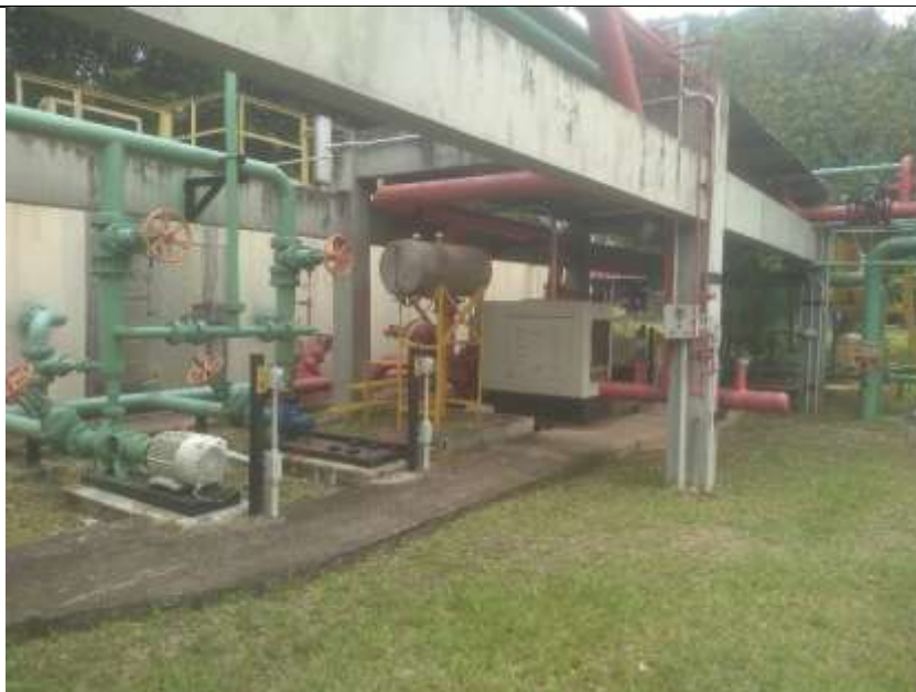
Figura 7 – C.M.I sem extintor CO2
