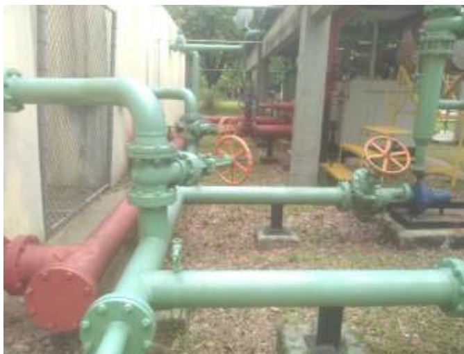
Figura 9 – Prumadas de tubulação de cor verde
