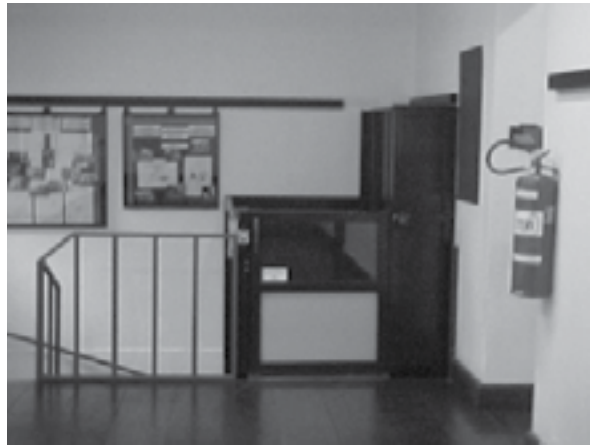
Museu J. José Felizardo, Porto Alegre: elevador de acesso para pessoas em cadeira de rodas
