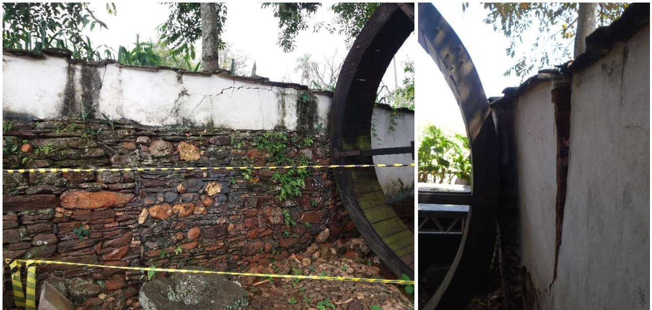
Trinca na parte esquerda e rachadura na parte direita, com muro escorado pela peça acervo do Museu
