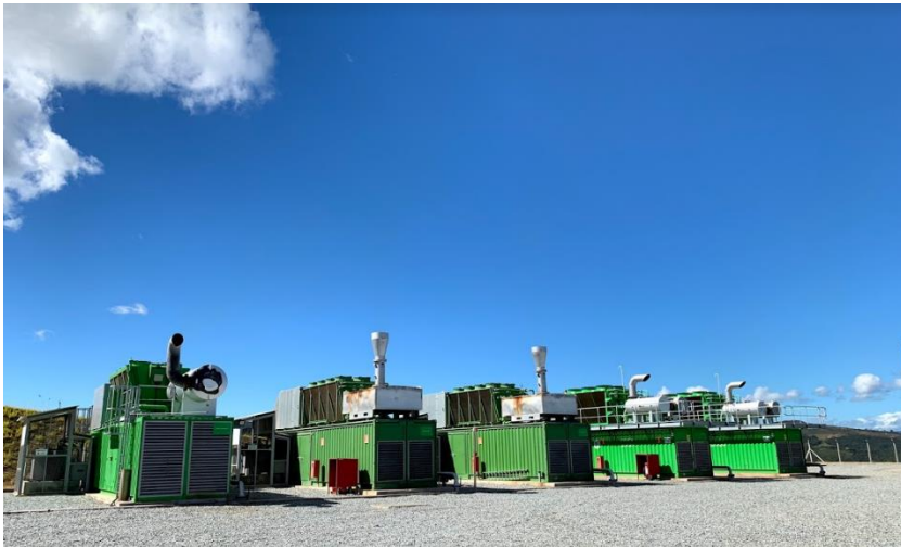
Planta de biogás de aterro sanitário – Asja Sabará.
