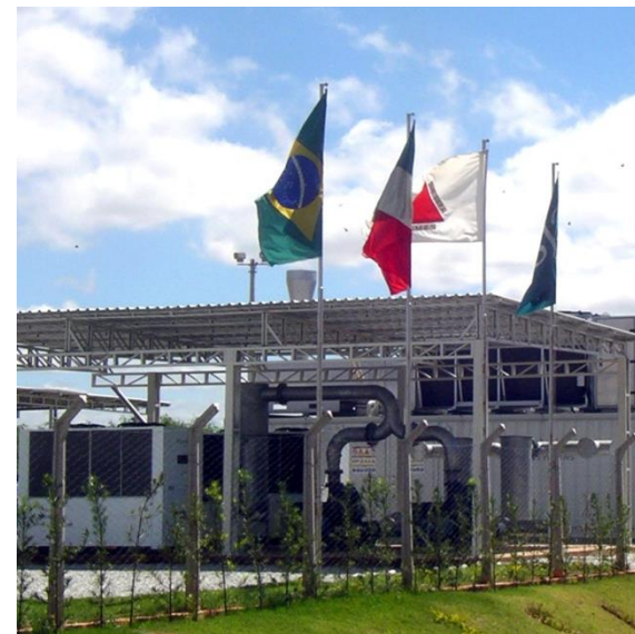
Planta de biogás de aterro sanitário Belo Horizonte (Minas Gerais - Brasil)
