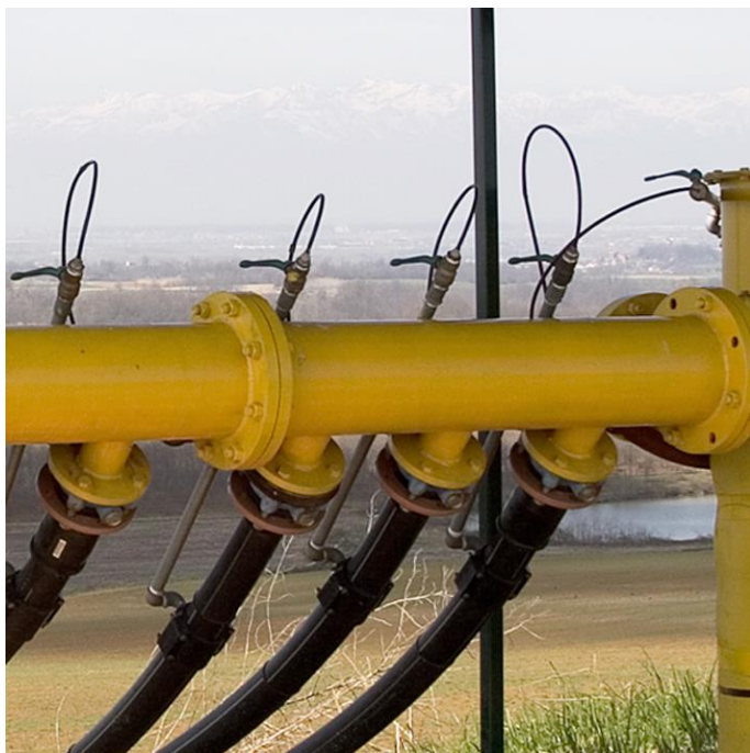
Subestação de regulação.
