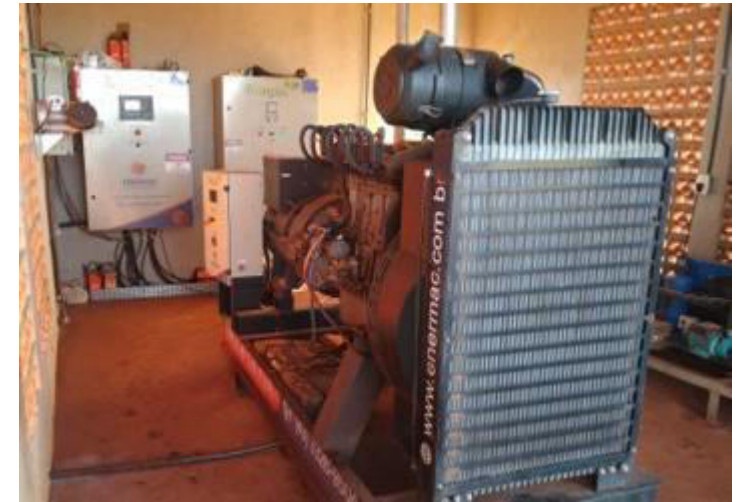
Grupo gerador a biogás, Toledo (PR).
