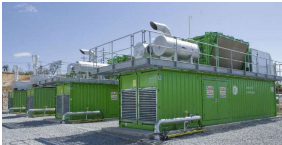
Figura 25 – Instalação em série de motogeradores a biogás (sistema modular em contêiner)
