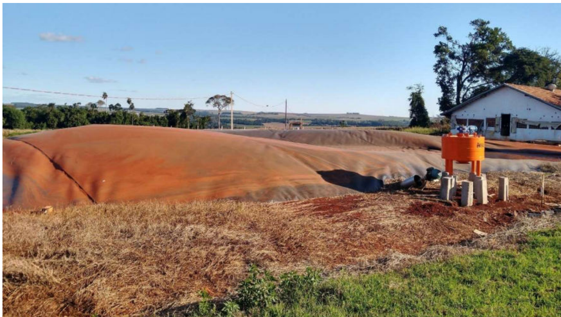
Figura 6 – Biodigestor BLC em Toledo
