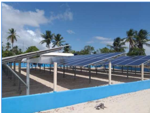
Figura 3 – Arranjo fotovoltaico (Fonte: Acervo Eletrobras)
