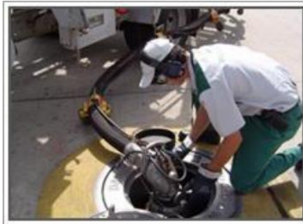
Rede Subterrânea de Hidrantes
