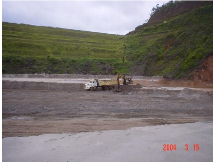
Vista da Superfície dos Rejeitos Lançados alguns dias após a paralização do lançamento
