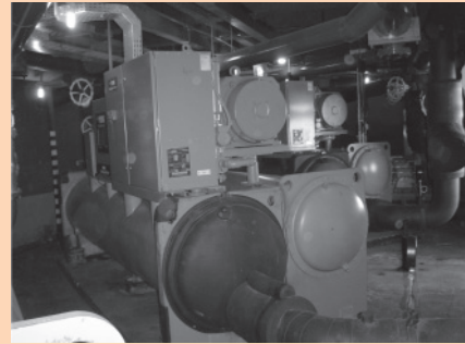
Resfriador Centrífugo de Líquido Millenium Tipo YK VSD Fabricação York.
