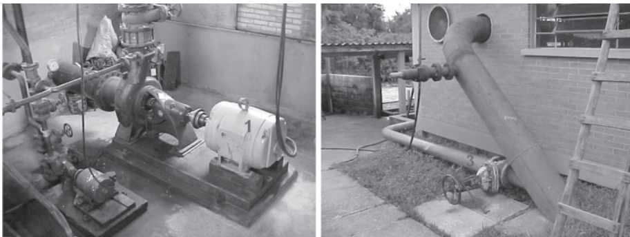
Figura 3.26 - Bomba de Captação
