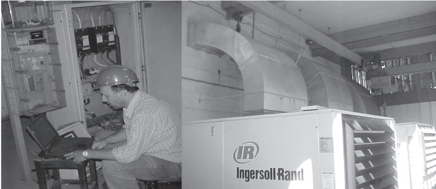
Figura 5.16 - Medições elétricas e dutos de ar do resfriamento dos compressores
