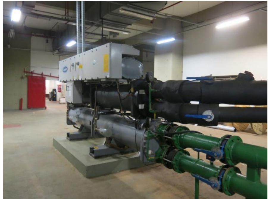
Chiller. Fonte: Mitsidi Projetos.
