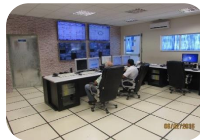
Procedimento de desligamento de equipamentos e lâmpadas
