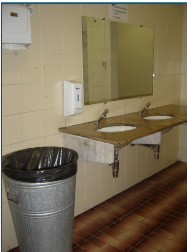
Foto 04 - Bancada com apoios em mármore
