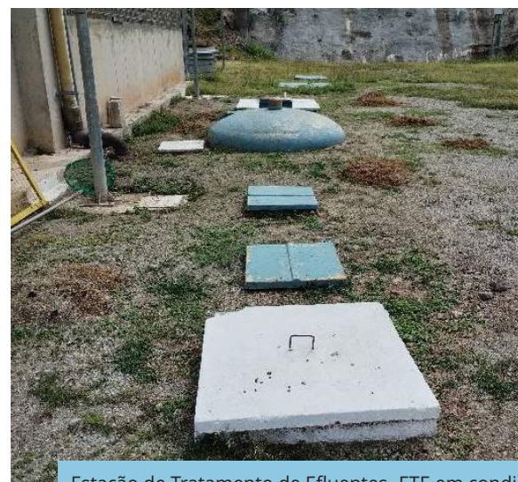
Estação de Tratamento de Efluentes -ETE em condições adequadas de funcionamento, na Estação de Bombeamento - EBV-1, Trecho V, Eixo Leste do PISF.
