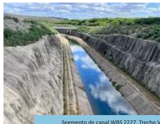
Segmento de canal WBS 2227, Trecho V, Eixo Leste do PISF em Monteiro/PB.
