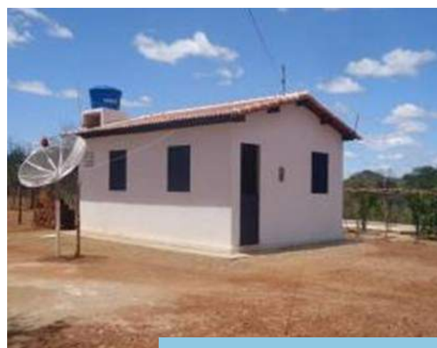
Construção de casas de alvenaria em substituição às de taipa, nas comunidades quilombolas.
