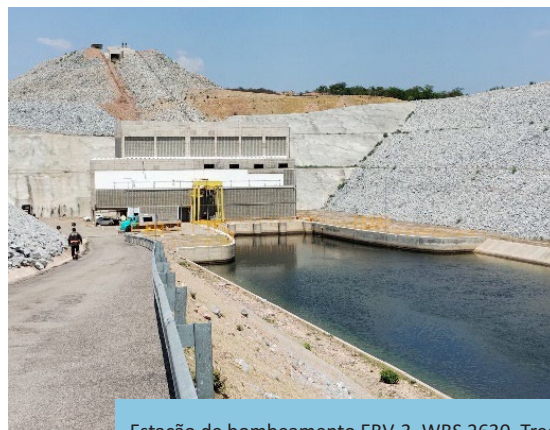
Estação de bombeamento EBV-3, WBS 2630, Trecho V, Eixo Leste do PISF, em Floresta/PE (jan/2025).
