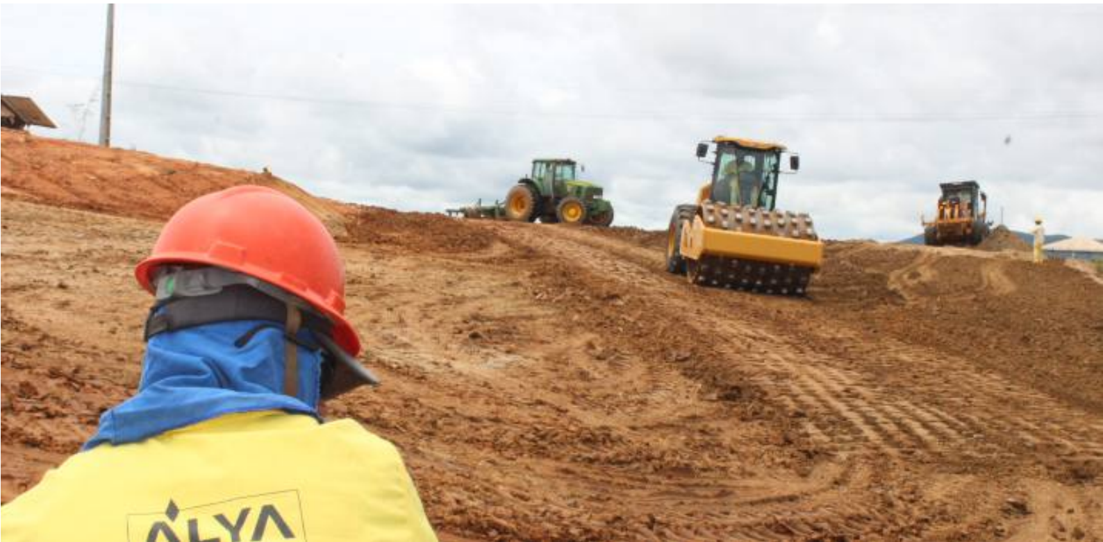
Atividade de terraplenagem próximo ao Sifão 420 (WBS 4065). Município de Cachoeira dos Índios/PB.
