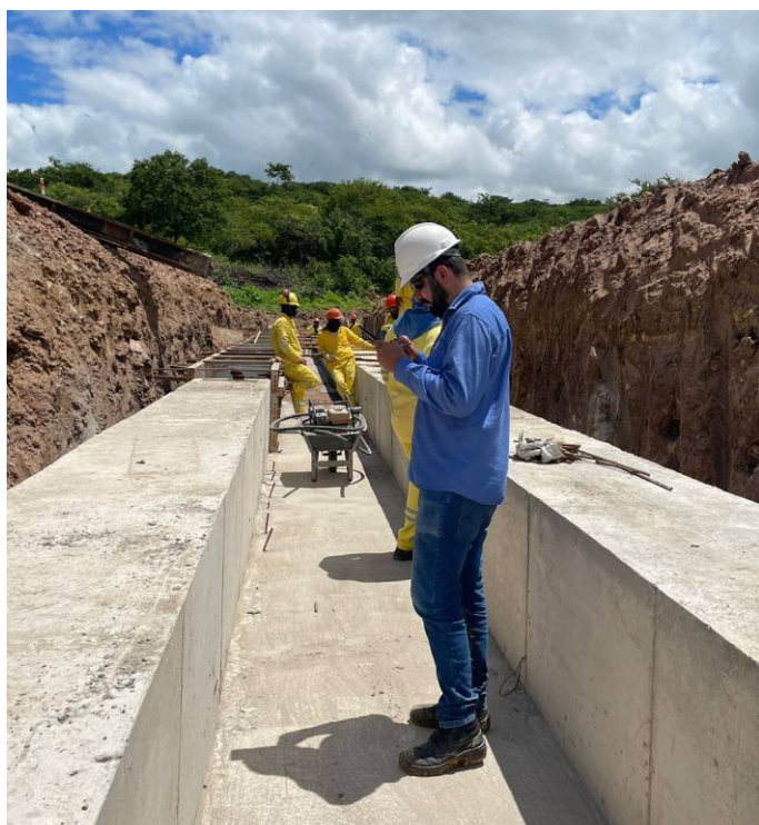
Estrutura instalada no segmento de canal 13 (WBS 4239) para passagem de adutora. Município de Santa Helena/PB.
