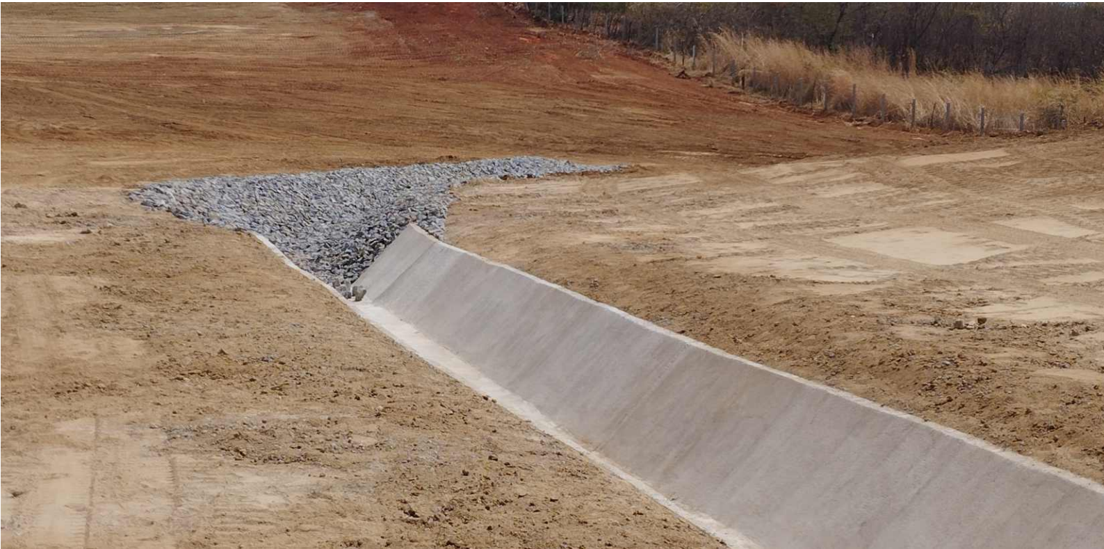
Implantação de medida de controle - Canaleta de direcionamento das águas pluviais.
