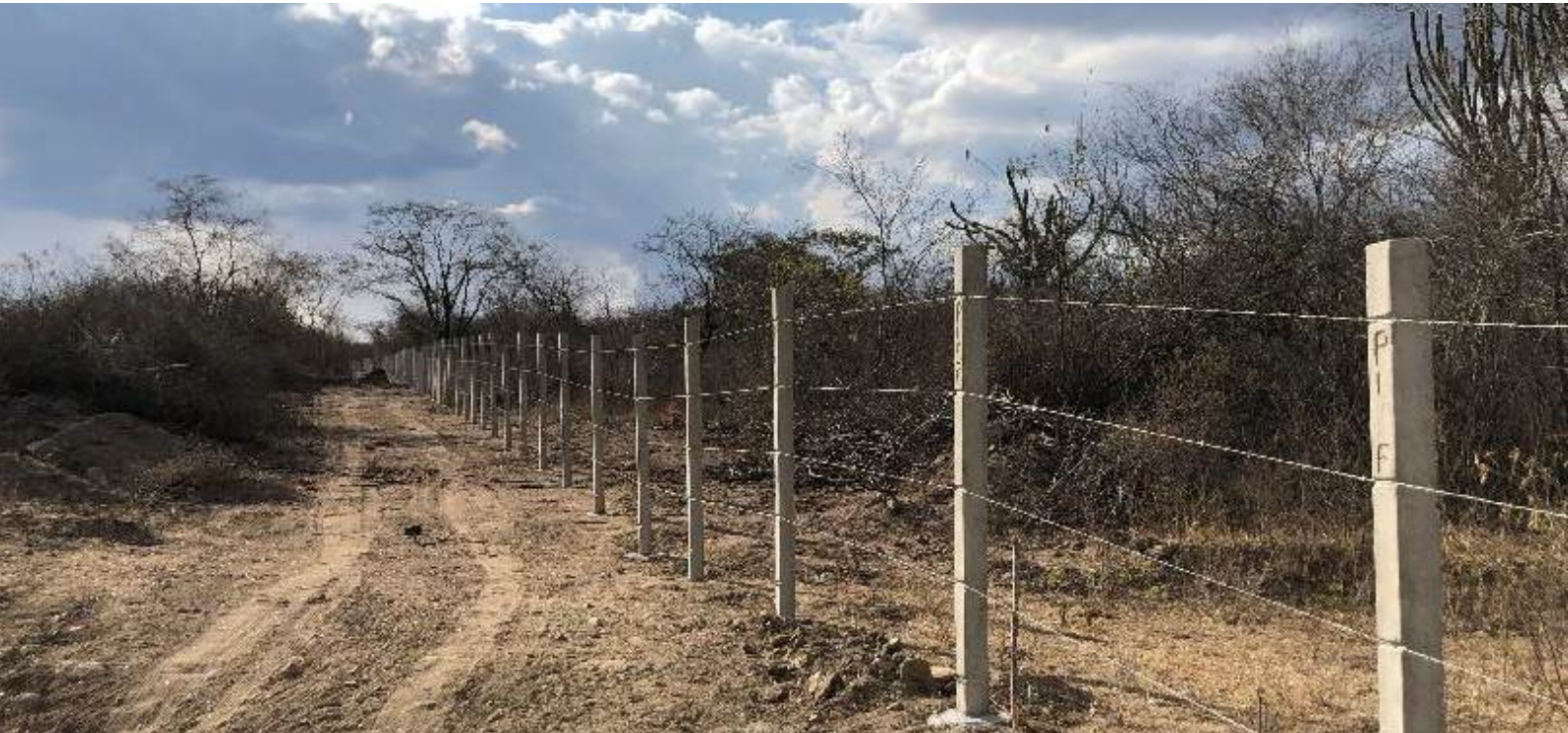
Cercamento implantado no entorno do reservatório Ipojuca. Arcoverde/PE. Serviços de cercamento concluídos em outubro/2023.
