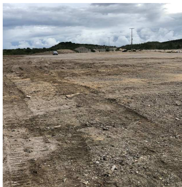
Desmobilização de instalações (área do antigo canteiro do segmento de canal C9).
