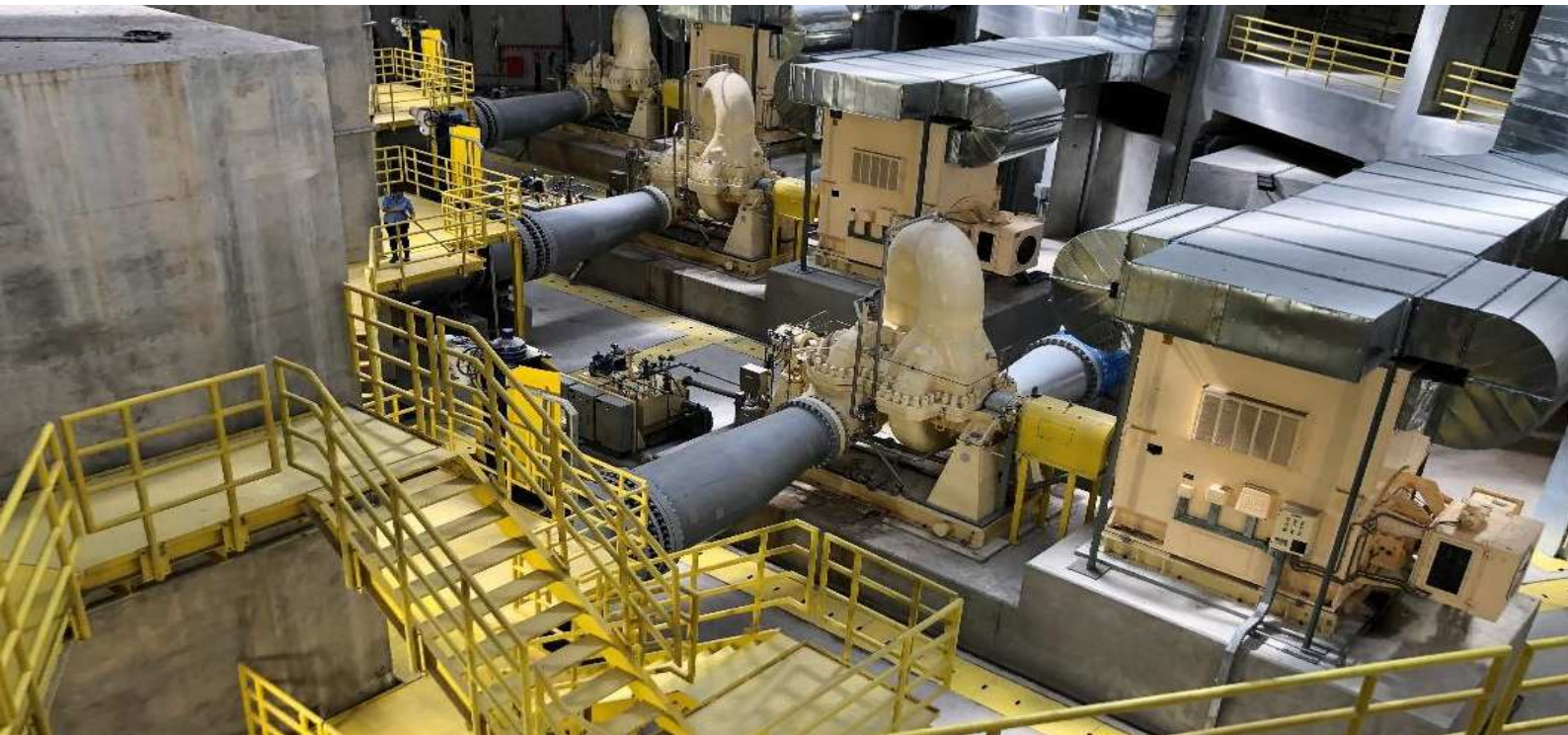
Vista interna da Estação de Bombeamento - EB VII-1. Sertânia/PE.
