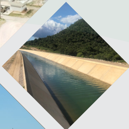
Segmento de Canal
